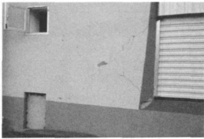
图6 墙体交叉斜裂缝
