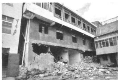
图2 一层外纵墙体坍塌
