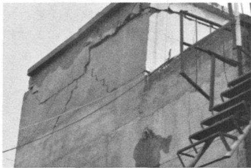
图8 顶层山墙严重开裂
