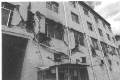
图1 二层外纵墙严重破坏
