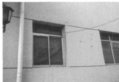
图4 二层外纵墙轻微裂缝
