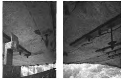
图3 底板纵向贯通裂缝
