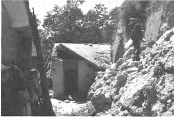
图2 凤州褚家崖崩塌
