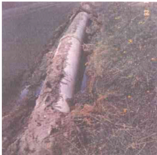
图8 地震时非液化地基中管线的上浮
