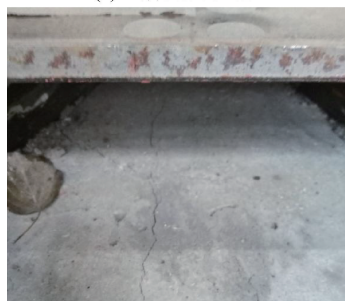
(b) 试件顶面裂缝
